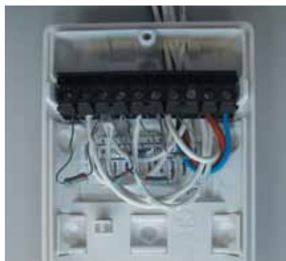
Cableado de resistencia convencional
